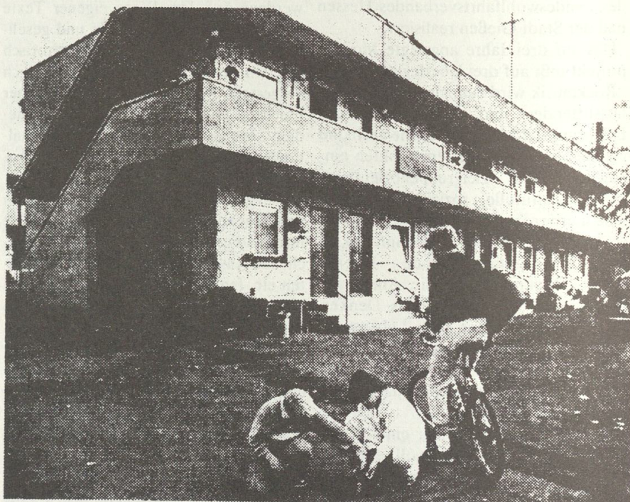
Typischer Schlichtwohnungsbau in der Gießener Margaretenhütte. Die dünnen Wände bieten den Anwohnern kaum Schutz vor klirrender Kälte.
